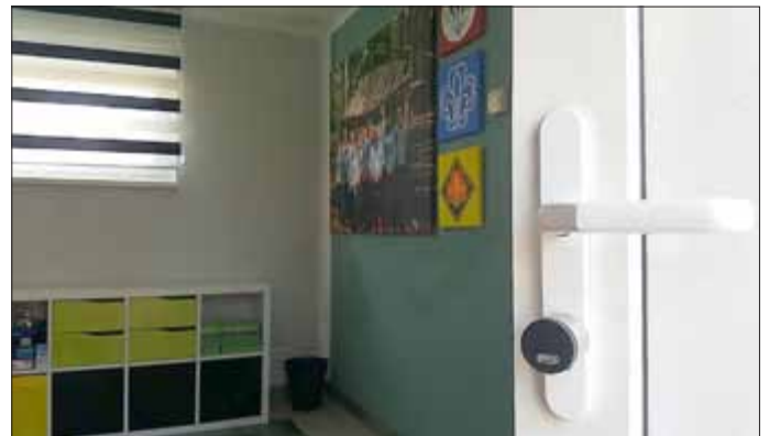
Eingangstür des Pfadfinderzentrums Drei Gleichen mit elektronischer Airkey Schließanlage von EVVA
